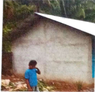
Foto 1: Se observa que ya finalizaron con la colocación de los block en las paredes y el repello de las mismas.
