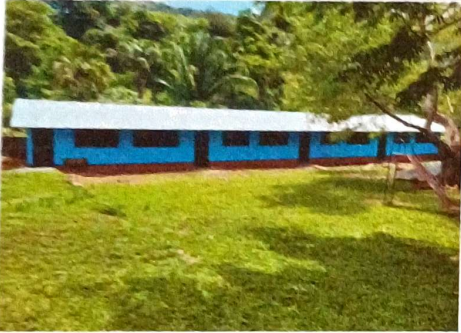
Foto 3: Se observa la finalización de la colocación de láminas y las paredes de las aulas terminadas.
